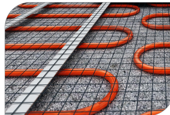
podlahové topení | underfloor heating
